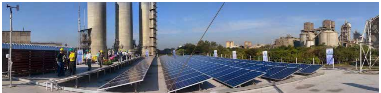
รูปที่ 2.5 : การผลิตไฟฟ้าพลังงานแสงอาทิตย์ติดตั้งบนดาดฟ้าอาคารสำนักงาน ขนาดกำลังการผลิต 49 กิโลวัตต์สูงสุด ที่อำเภอท่าลาน จังหวัดสระบุรี เป็นการผลิตไฟฟ้าเพื่อใช้งานภายในโรงงานมิได้ขายไฟฟ้า (ที่มา : บริษัท เอส ซี ไอ อีโค เซอร์วิส เซส จำกัด)
